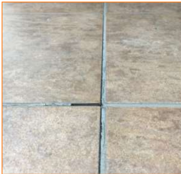
Rottura della fuga
