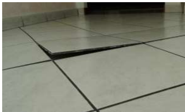
Danni da dilatazioni non compensate
